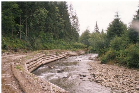
Рисунок 1.10 – Деревозрубова підпірна стіна на автомобільній дорозі Чернівці – Руська (р. Черемош)
