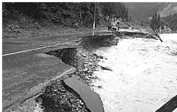
Рисунок 1.8 – Зруйноване земляне полотно дороги
