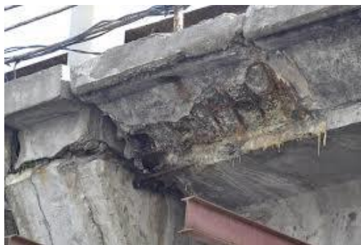
Рисунок 4.1 – Корозія арматури балки Шулявського мосту в Києві
