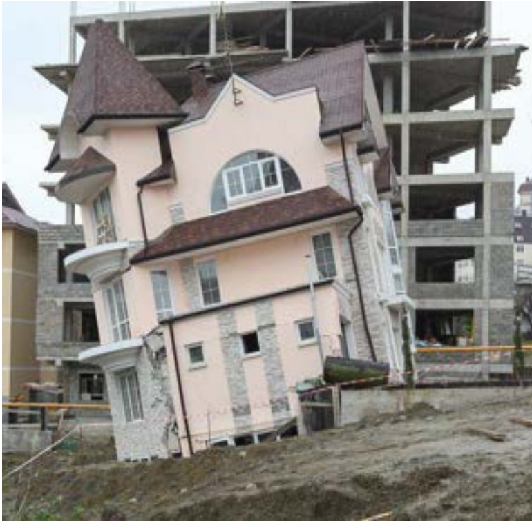
Рис. 4.35. Зсув ґрунту під дією маси нової будівлі (д)
