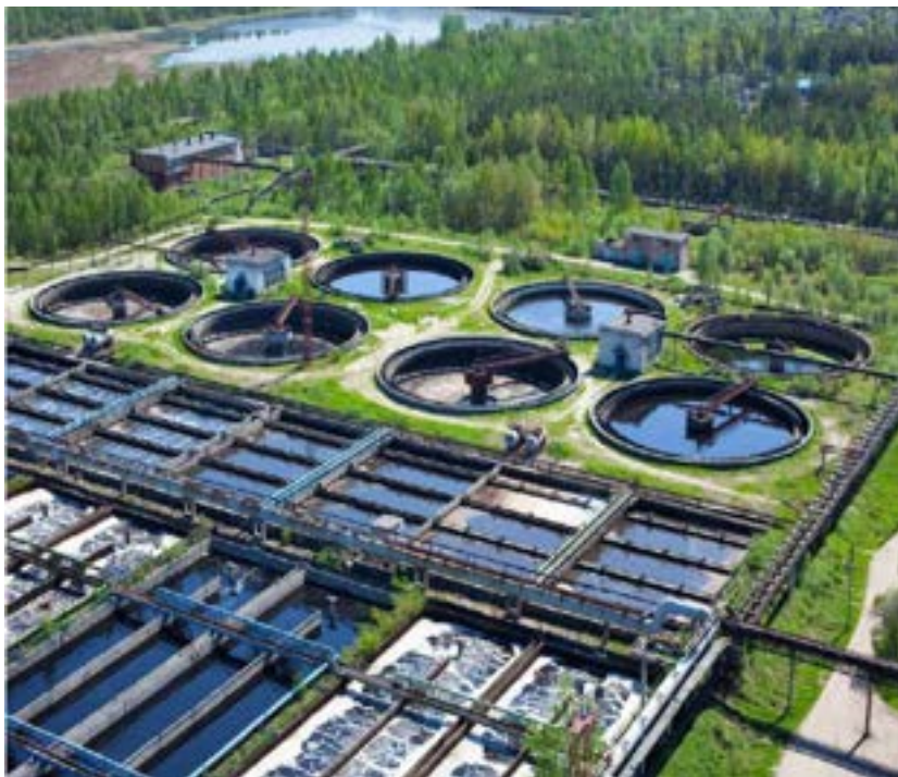
Рис. 1.26. Загальний вигляд очисних споруд
