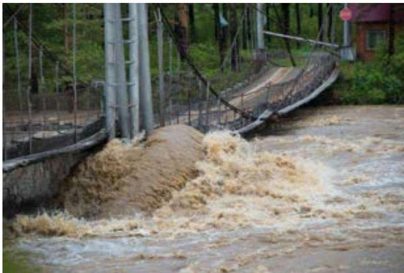
Рис. 1.99. Підмивання опори моста бурхливим потоком
