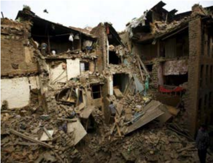
Рис. 4.13. Руйнування цегляного будинку під час землетрусу
