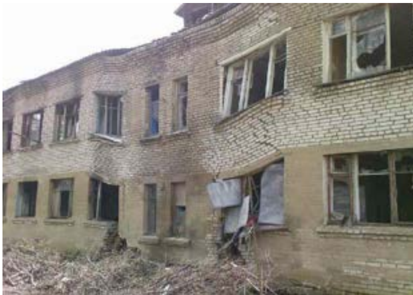
Рис. 4.33. Деформація будинку внаслідок розташування лінз слабких ґрунтів під частиною фундаменту (в)
