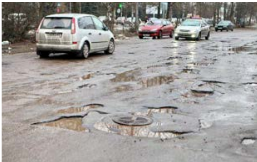
Рис. 1.18. Стан дороги після проведеного неякісного ремонту
