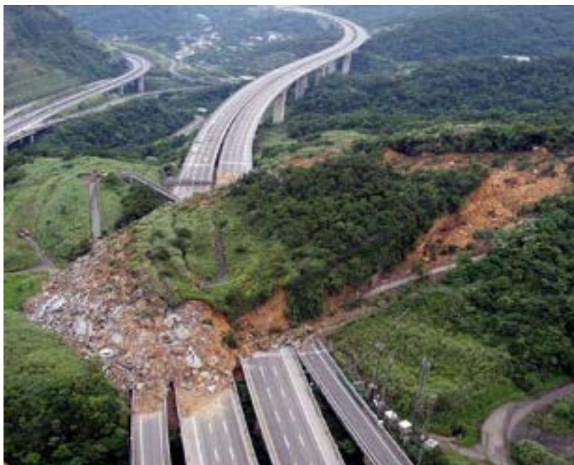
Рис. 1.47. Потужний зсув, що був спровокований землетрусом.
