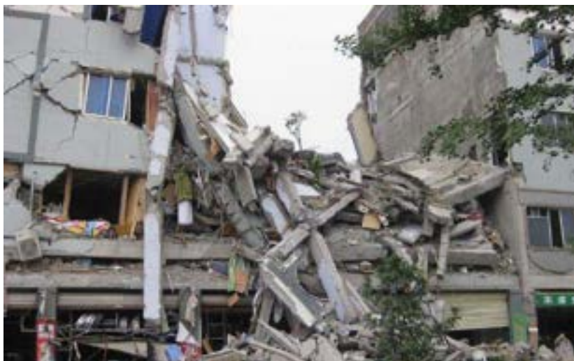
Рис. 4.15. Руїнування великопанельного будинку під час землетрусу
