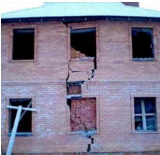
Рис. 4.34. Утворення центральної тріщини внаслідок нерівномірного просідання через наявність окремих ущільнених ділянок в ґрунтах основи (г)
