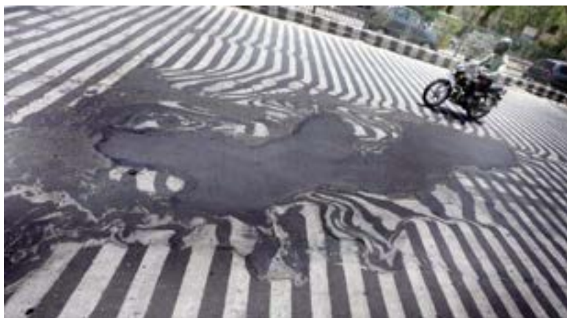
Рис. 1.78. Під впливом високої температури деформувався дорожній настил
