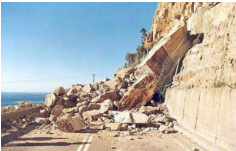
Рис. 1.48. Обвал внаслідок прорахунків з укріплення схилу
