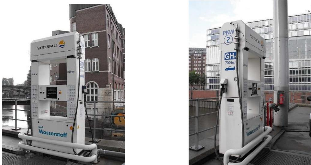
Рисунок 1.23 – Приклад водневої заправної станції на 700 бар (Ваттенфаль-Гамбург, Німеччина)
