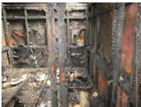
Зображення 12. Вигляд пошкодженого приміщення
