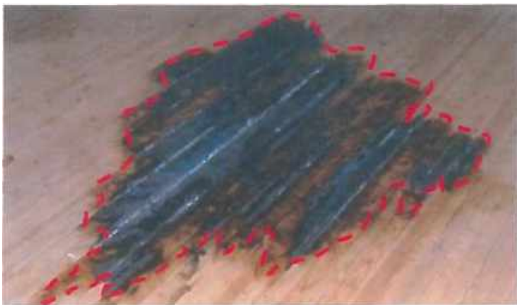
Рис.57. Зображення плями від згорілих ЛЗР чи ГР на деревині підлоги приміщення
