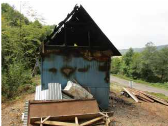
Зображення 6. Вигляд пошкодженої будівлі
