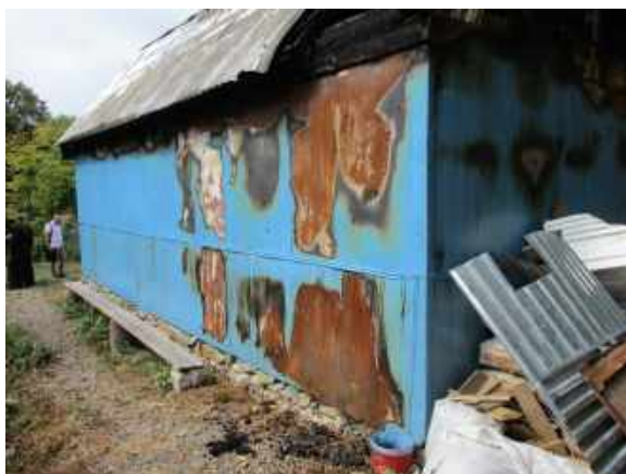
Зображення 3. Вигляд пошкодженої будівлі
