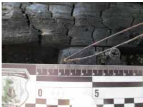
Зображення 13. Вигляд електричних проводів з ознаками короткого замикання
