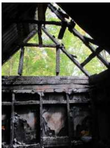
Зображення 10. Вигляд пошкодженого приміщення
