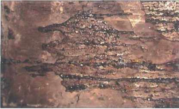
Рис.60. Звуглені залишки полімерного матеріалу в місці його вигорання
