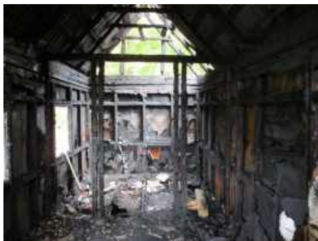
Зображення 11. Вигляд пошкодженого приміщення
