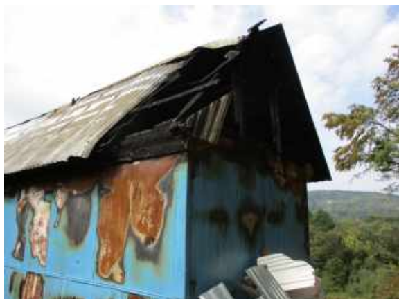
Зображення 4. Вигляд пошкодженої покрівлі
