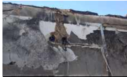
Зображення 4. Вигляд електромережі та електричної розподільчої коробки
