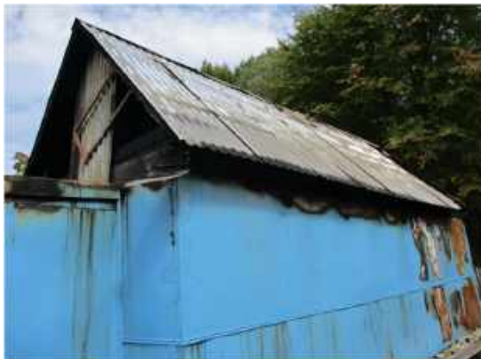
Зображення 2. Вигляд пошкодженої будівлі
