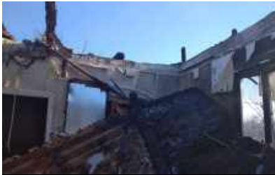
Зображення 3. Вигляд пошкодженого приміщення
