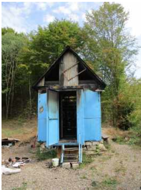
Зображення 1. Вигляд пошкодженої будівлі
