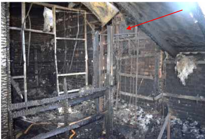
Зображення 5. Вигляд частини приміщення при вході зліва Примітка: стрілкою червоного кольору позначено місце розташування металевого ящика
