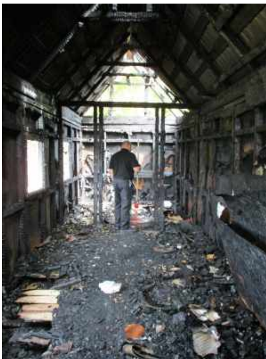
Зображення 7. Вигляд пошкодженого приміщення
