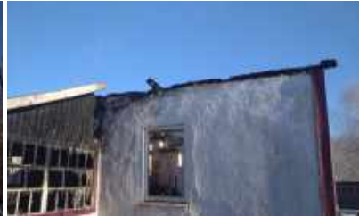
Зображення 2. Вигляд пошкодженої будівлі
