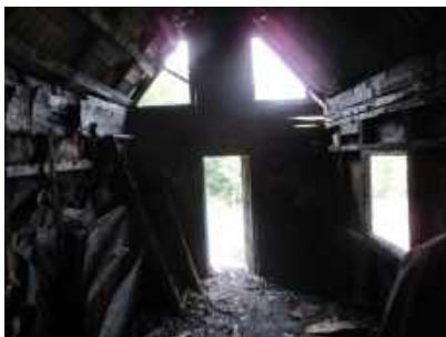
Зображення 8. Вигляд пошкодженого приміщення
