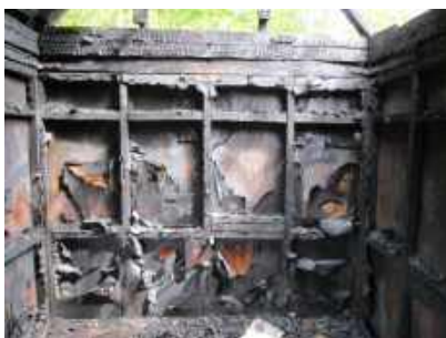
Зображення 9. Вигляд пошкодженого приміщення
