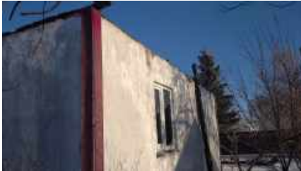
Зображення 1. Вигляд пошкодженої будівлі
