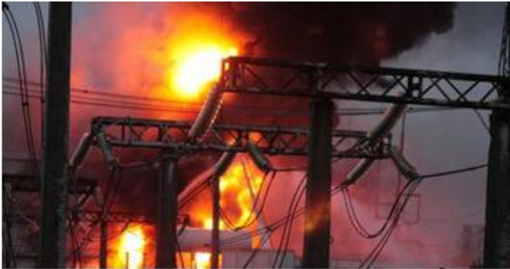
Рисунок 1.2 – Пожежа на об'єкті електромереж
